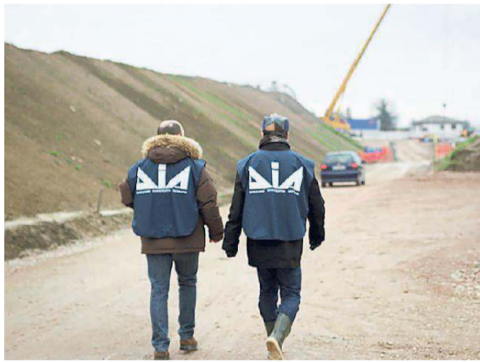
Un controllo della Dia in un cantiere stradale in provincia di Padova
